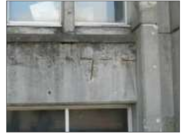
【外壁の鉄筋露出】
