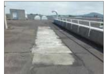
【屋上の仕上剥離】
