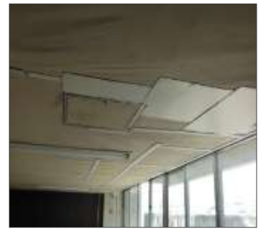
【室内天井の剥がれ】
