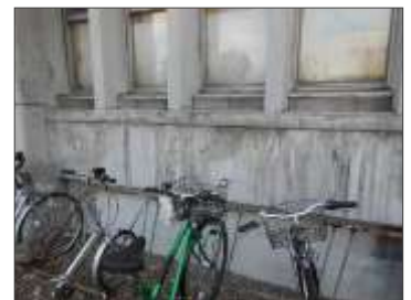
【外壁の仕上剥離】
