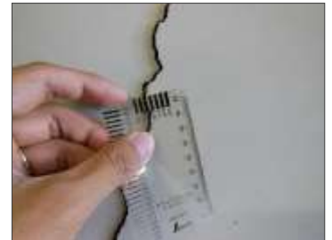
【室内コンクリート壁のクラック】
