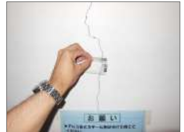
【室内コンクリート壁のクラック】
