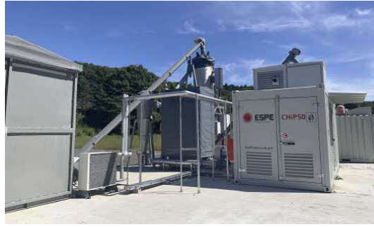
▲木質バイオマス発電設備
